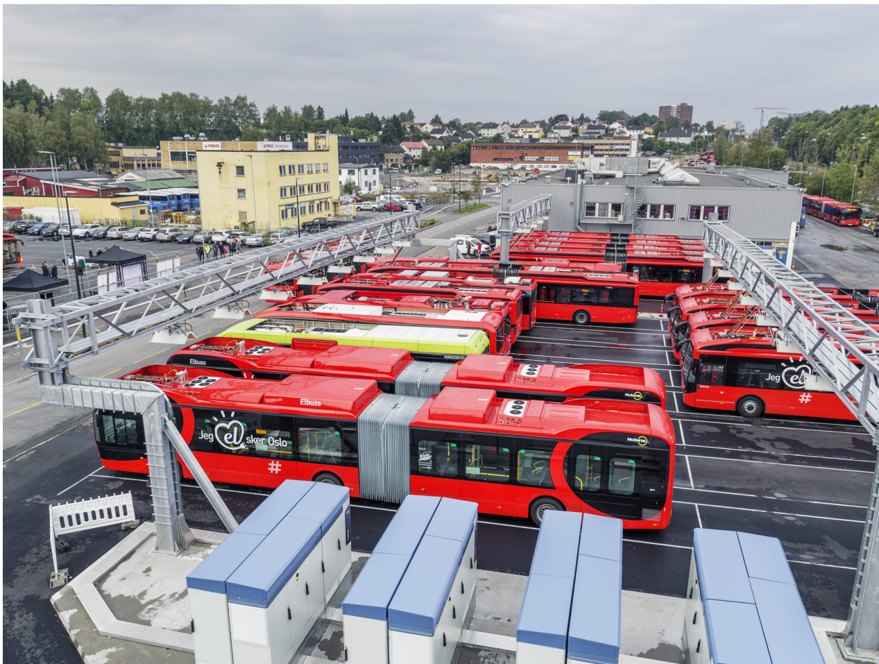
Elbusser lader på Nordens største ladeanlegg for busser på Alnabru, der 30 busser kan lades samtidig. Foto: Ruter As / Redink, Daniel Ashby
